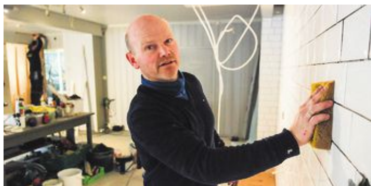
HELE FAMILIEN TRÅR TIL: Ola Tveiten har jobbet med oppussing av kafeen den siste tiden – målet er å bli ferdig før januar er omme.
